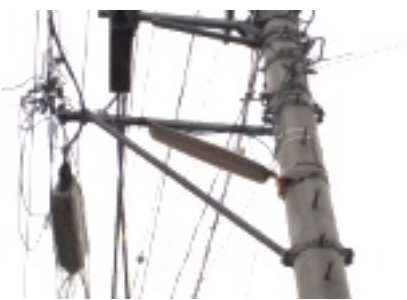
右従来の蛍光灯式道路照明灯。
